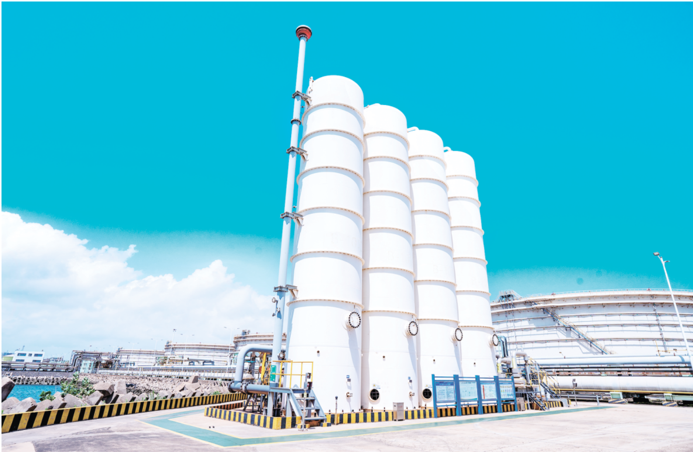
日照港码头旁高耸的油气吸收转接塔
