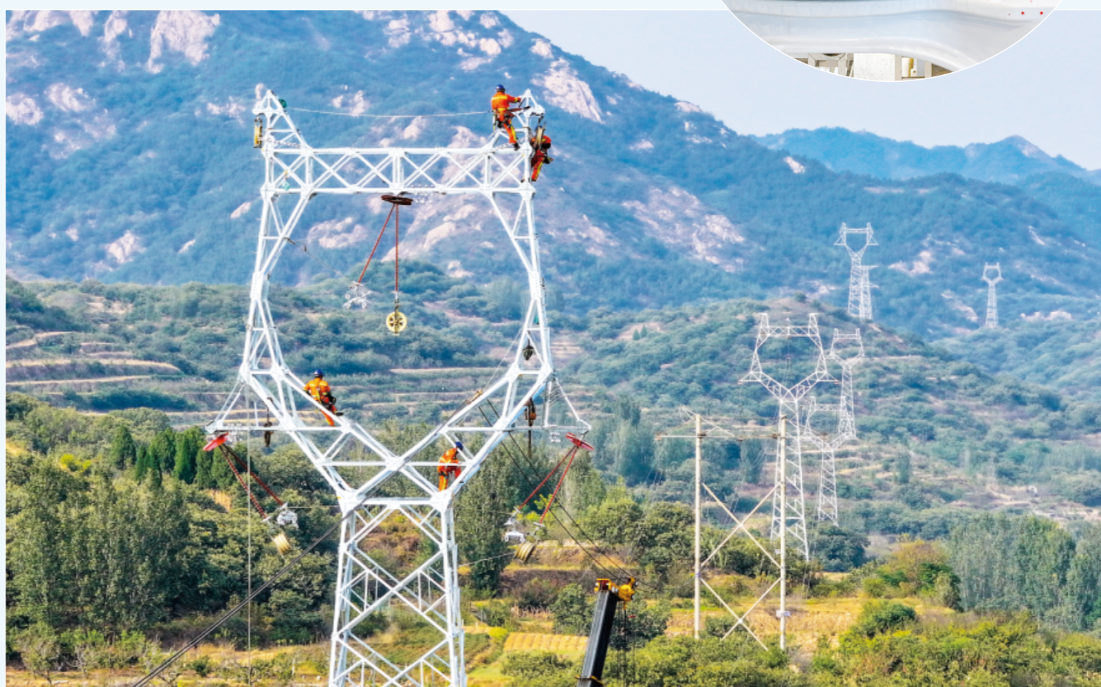
国网日照供电公司工作人员对220千伏莲蓬Ⅱ线杆塔进行加高维修。
